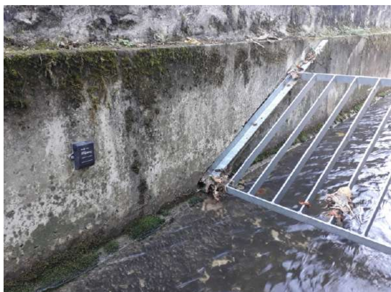
Installation pour suivi d'encrassement de grille
