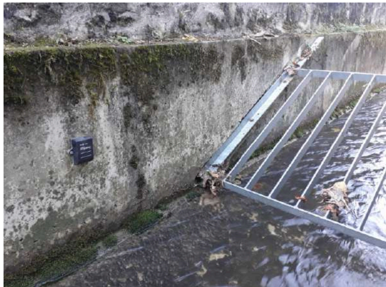
Installation pour suivi d'encrassement de grille
