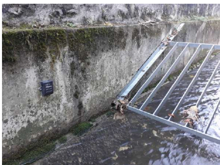
Installation pour suivi d'encrassement de grille
