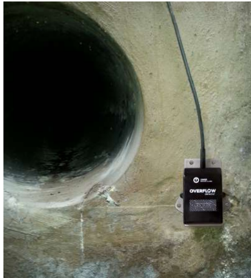
Installation en déversoir d'orage
