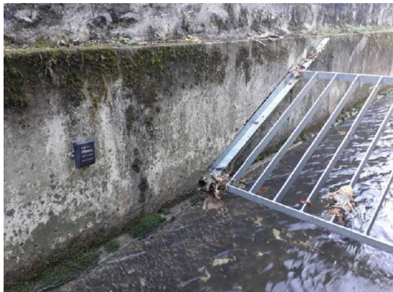
Installation pour suivi d'encrassement de grille
