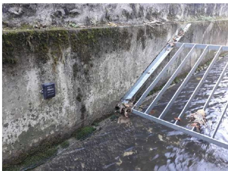
Installation pour suivi d'encrassement de grille
