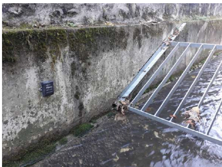
Installation pour suivi d'encrassement de grille
