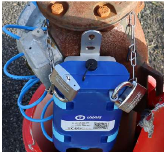
Installation avec cadenas
